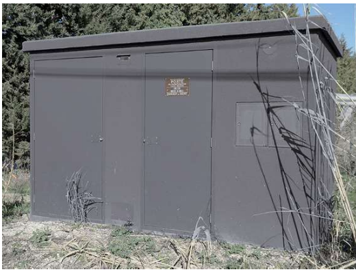
ILLUSTRATION DU POSTE DE LIVRAISON
